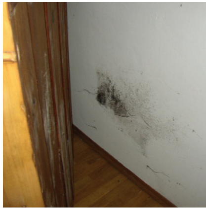
Punkt förmige Wärmebrücke (Fehlstelle bei Vermauerung)
