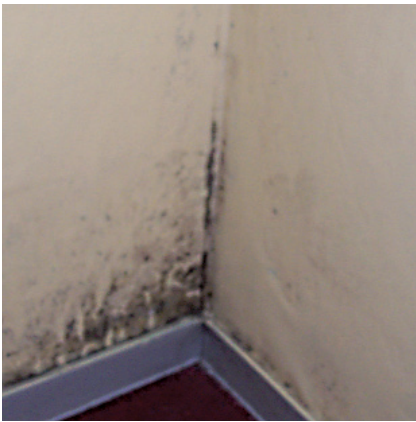
Wärmebrücke im Eckbereich Außenwand mit Schimmelbefall
